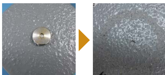
全てグレー色のため、改修時期がわからない
